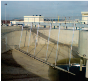
Çöktürme Havuzu Sıyırıcı Köprüler Sedimentation Tank Scraper Bridges
